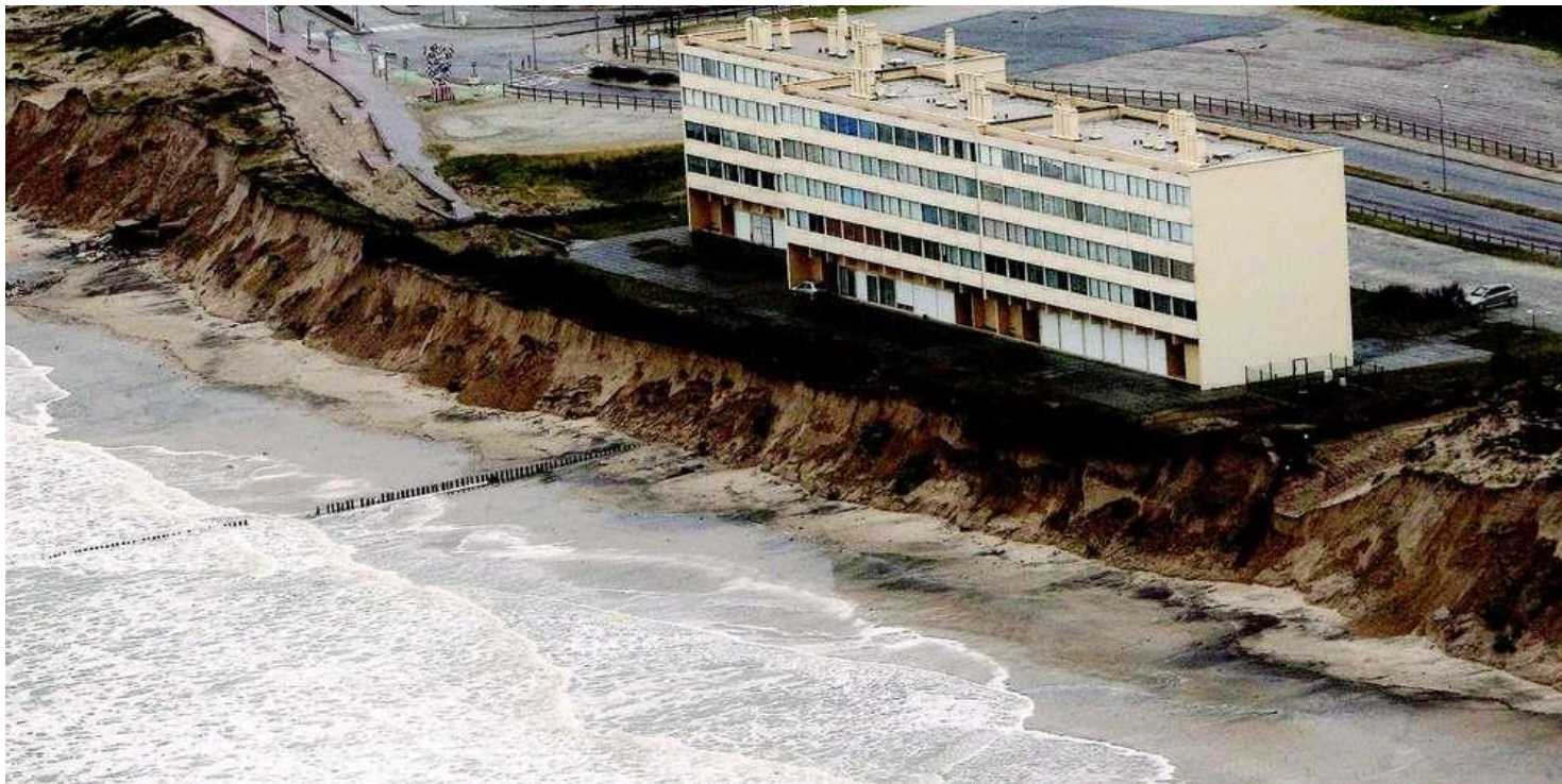
Image n° 2 : Immeuble « Le Signal » de Soulac-sur-Mer (Gironde) évacué à cause de la montée des eaux.
